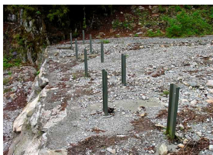
Photo 2.22 : Piège à flottants - Eaux Bonnes
