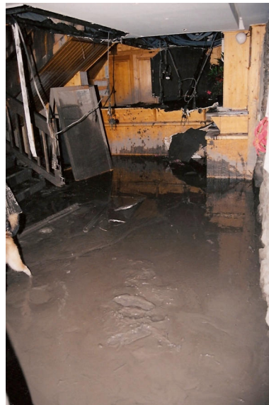
Les dégâts au niveau inférieur
