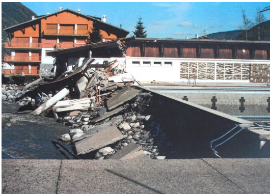
Photo 6.10 : Saint-Lary 1982, dégâts à la piscine
